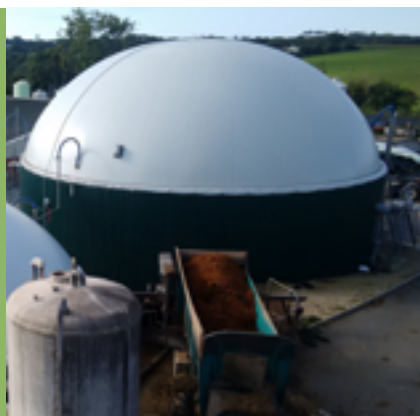
Stoccaggio del digestato con recupero del biogas
